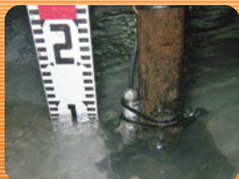
圧力式水位計設置状況
