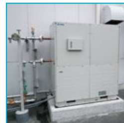
地中熱ヒートポンプ (ゼネラルヒートポンプ工業社製)
