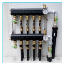
地中熱側ヘッダー管 (伊・CALEFF社製)
