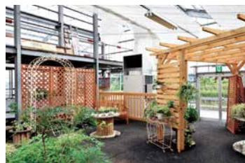
施設内ヒートポンプ設置状況
