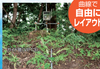
＜フレキシブル伸縮計＞
