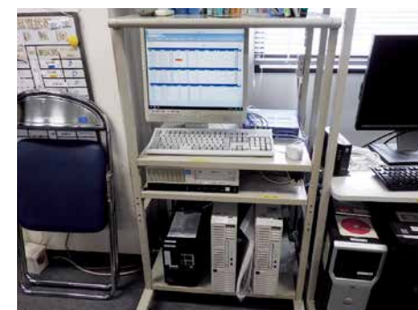
遠隔監視サーバ
