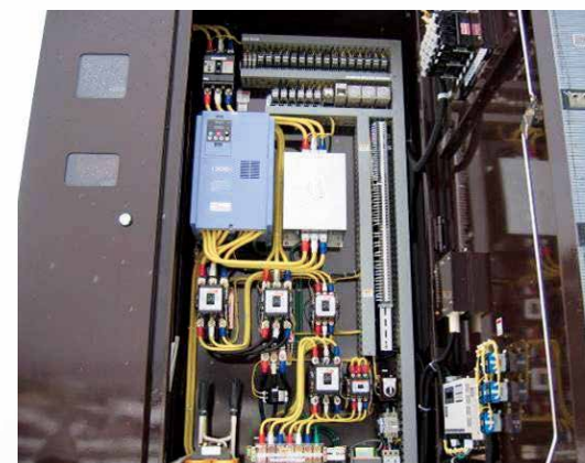
インバータ制御システム制御盤
