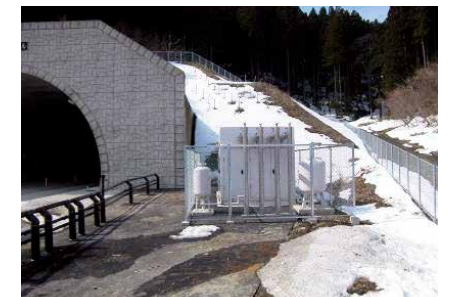
水熱源ヒートポンプ
