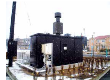
ガス焚き温水発生器ユニット
