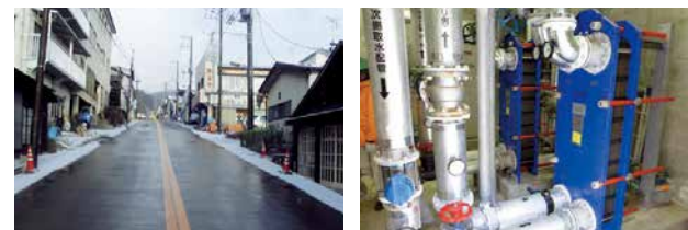
プレート式熱交換器利用 (栃木県那須町内、排湯利用)
