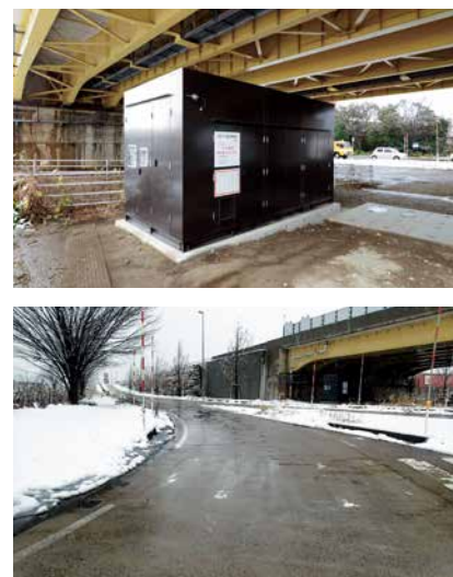
車道への設置事例（三田IC）
