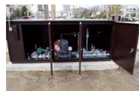
循環ポンプ(3.7kW)
