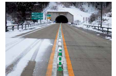
山形県鶴岡市【トンネル湧水】 （日本海東北道小波渡トンネル）
