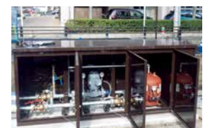
循環ポンプ(2.2kW)
