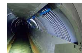
採熱ヘッダー(上流側)
