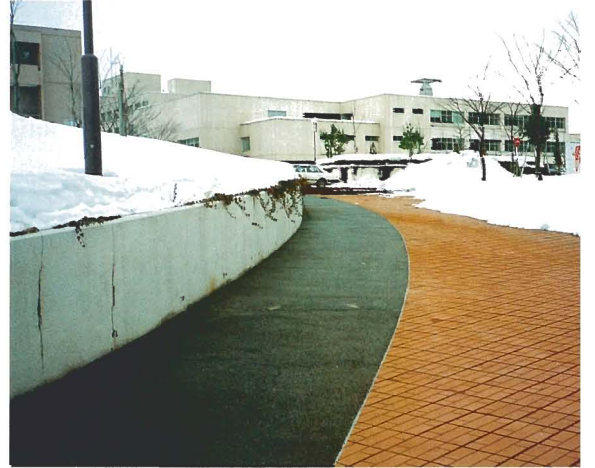
フラットタイプによる融雪状況
