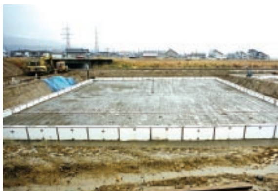
蓄熱部(駐車場下)
