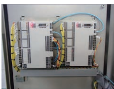
現地設置PLC
